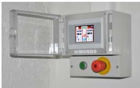
Panel de control con pantalla táctil del sistema domótico.
