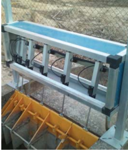
Imagen de una compuerta automatizada.
